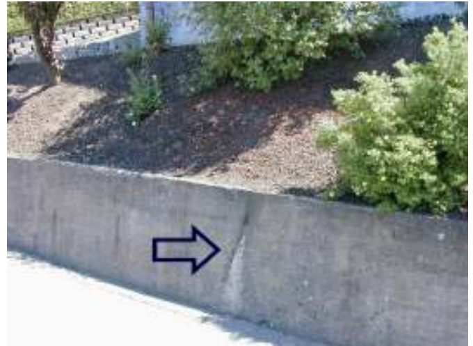
Fig 2 muestra el cordón con una rotura exactamente por encima de la falla. Se ve claramente la sección métrica del cordón. Además de este punto de rotura dado, la piedra también se partió en el medio.
