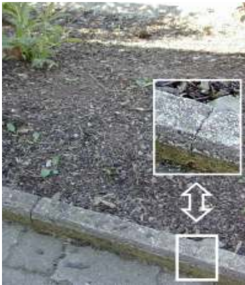
Fig 1 muestra la pared que da a la calle. Se puede ver claramente la rotura en la pared por encima de la falla detectada a. Ver flecha
